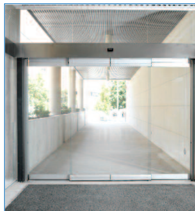
Salida de evacuación. Puerta automática con sistema antipánico integral sin perfilera vertical.
